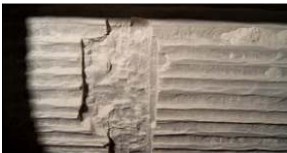
Walzenkörper mit Abplatzungen
