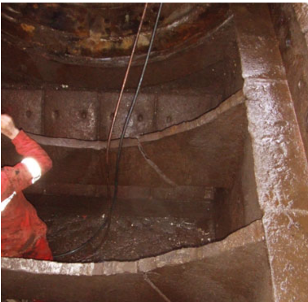
Vor der Reparatur
