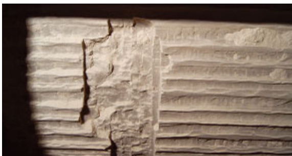
Walzenkörper mit Abplatzungen
